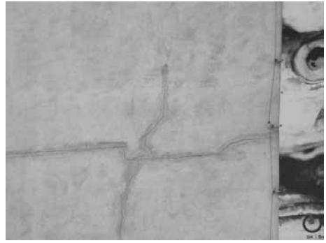
Detalhe da anomalia
