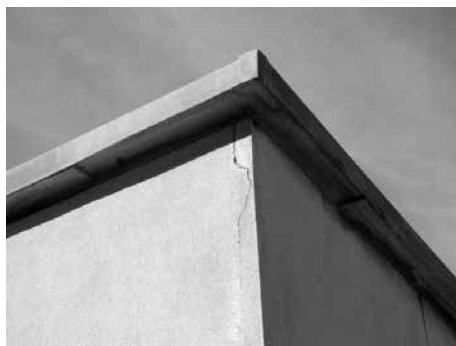
Detalhe da anomalia
