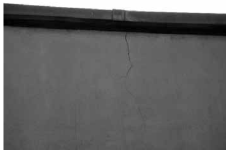
Detalhe da anomalia
