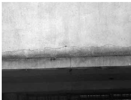
Detalhe da anomalia
