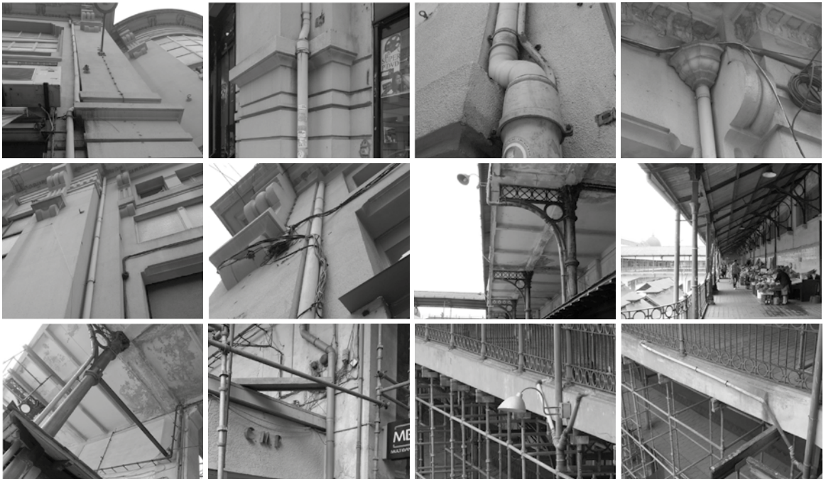
Fig. 23. "Não-valores": problemas diagnosticados na drenagem de águas pluviais existente fachada exterior e fachada interior.
