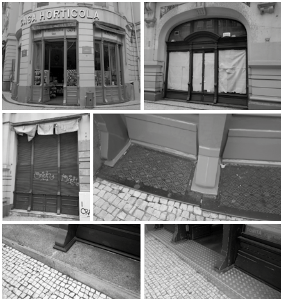
Fig. 25. Valores e "não-valores": caixilharia original em ferro fundido, soleiras originais e adulteradas.
