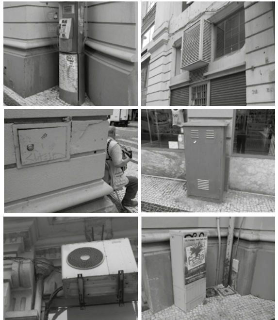
Fig. 26. "Não-valores": problemas diagnosticados com a introdução de infraestruturas nas fachadas exteriores do edifício.
