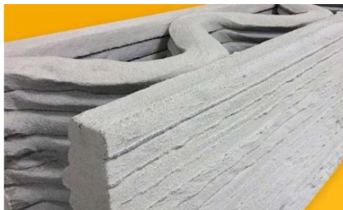
Figura 2.80 - Pormenor de parede impressa pela apis cor, com um filamento de reforço no interior (apis cor, 2016d).
