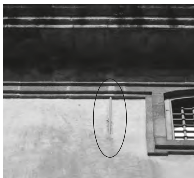
Fig. 60 Esmagamento do reboco nas amarrações dos tirantes T6 e T7 na parede da fachada lateral direita.
