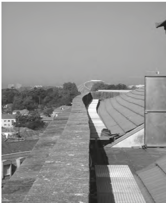
Fig. 59 Deformação das fachadas para fora do plano.
