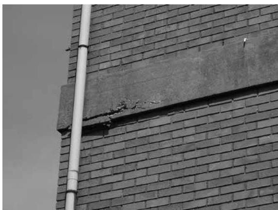
Fig. 04. Estado inicial - patologias em betão aparente
