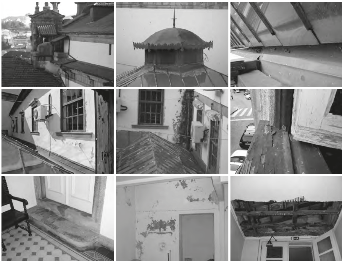
Fig. 11. Principais patologias da envolvente do edifício da sede da Santa Casa da Misericórdia do Porto (2010).
