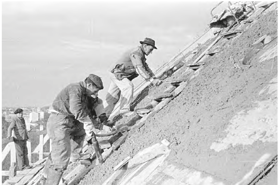
< Projeto de Estruturas original. Esquema de sobrecargas, [1951]. Interior da cúpula com o detalhe em betão translúcido, 1991. Betonagem da cobertura, 1954.
